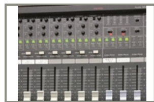
館内音響システム
