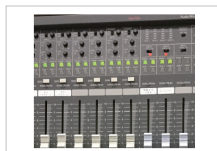
館内音響システム
